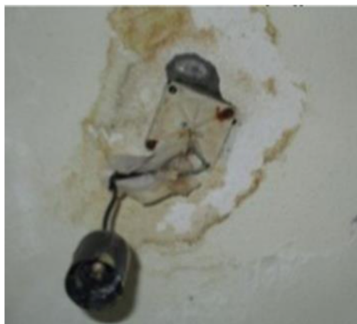
Figuur 2 Zo worden er vaak gevaarlijke situaties aangetroffen.
