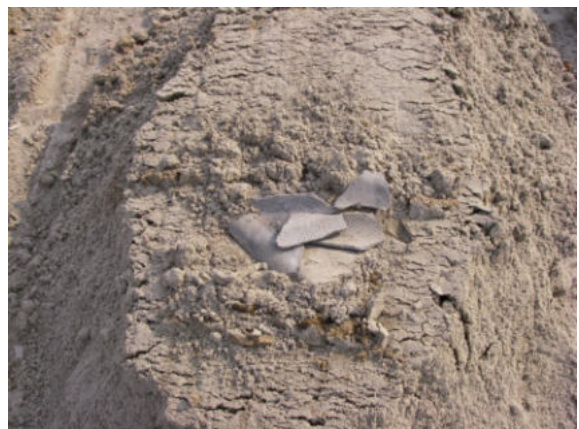
Asbestverdacht materiaal ASB03
