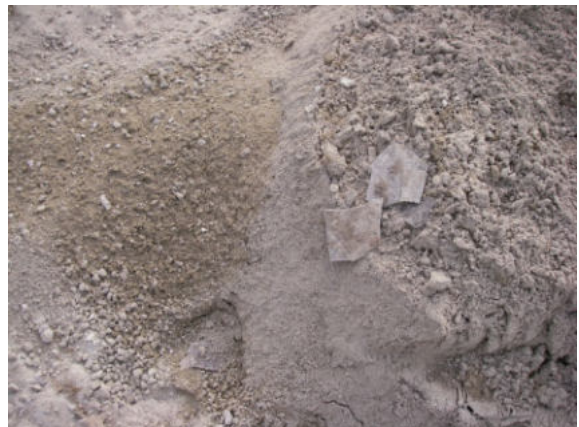
Asbestverdacht materiaal ASB02
